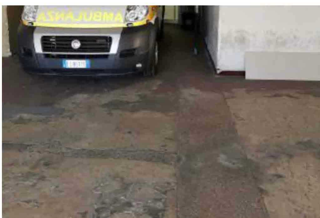
Un'altra zona in cui il pavimento risulta particolarmente rovinato
